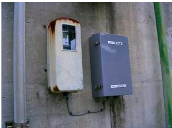
(写真3) デマンドコントロール装置本体(右)
