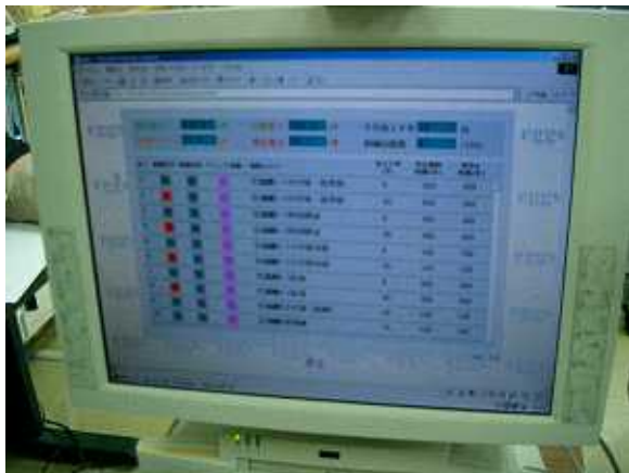
（写真2）デマンドコントロール装置操作端末
